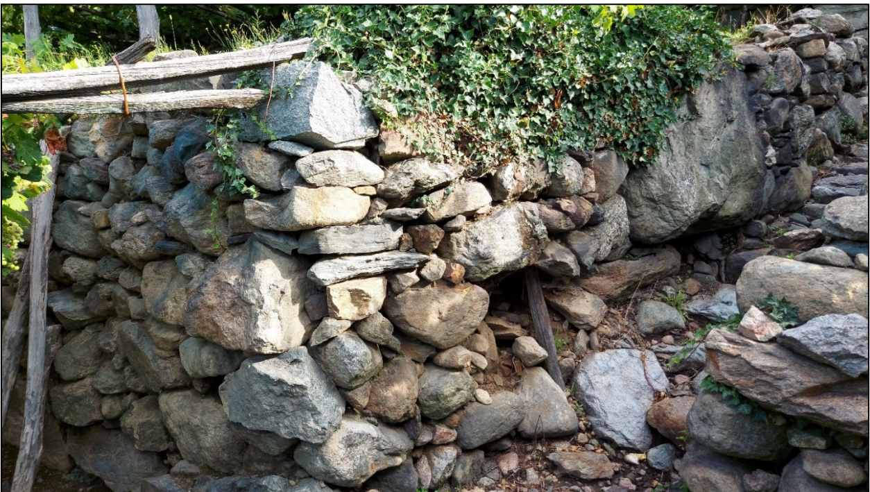
Nota esplicativa: Foto 4. Muro pericolante.
