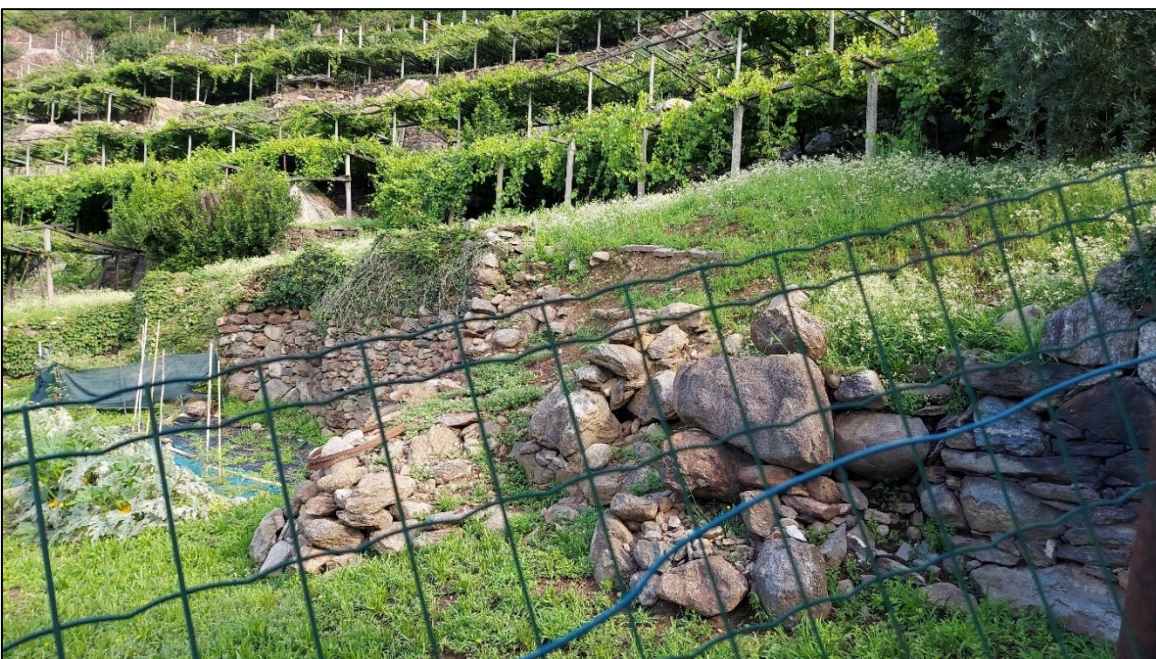
Nota esplicativa: Foto 6. Esempio di muro crollato da ricostruire.
